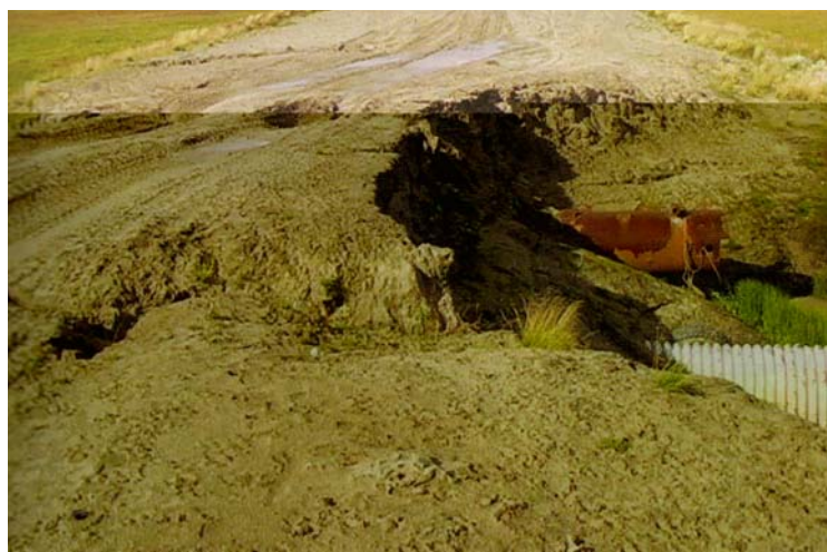
Рис. 3. Размыв откоса на выходе трубы из насыпи
