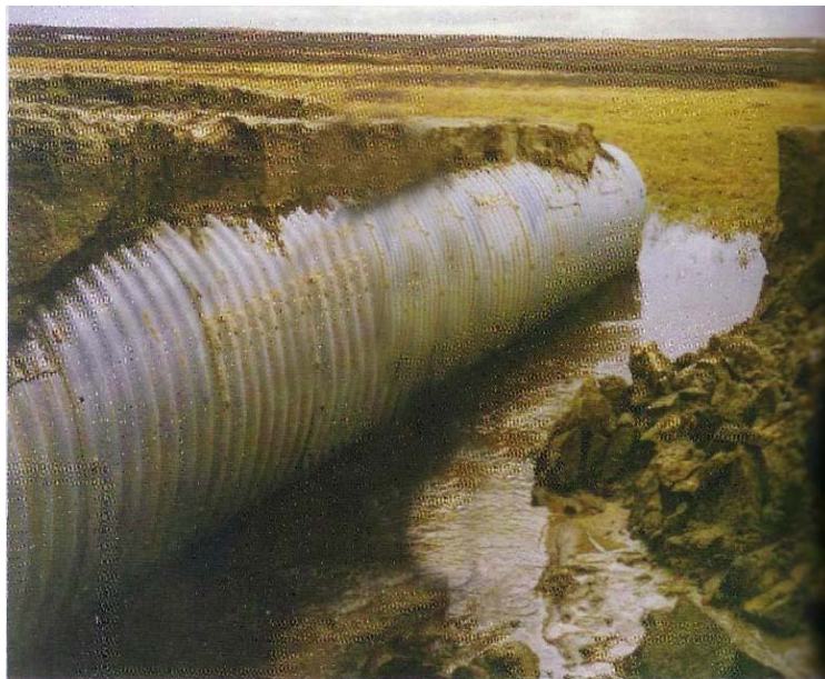
Рис. 2. Промоины вдоль труб
