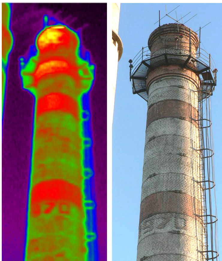
Рис. Термограмма и фотография верхней части дымовой трубы котельной с зоной сомоокутывания и дефектом оголовка
