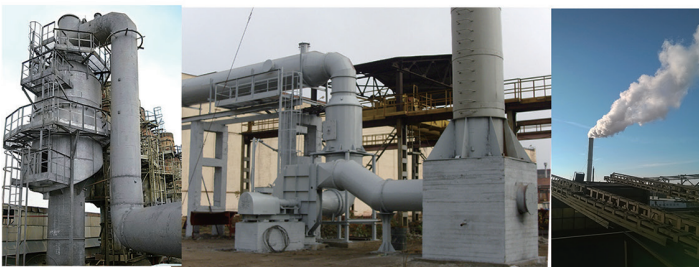
Системы мокрой пылегазоочистки: Минский тракторный завод, 2015г.
